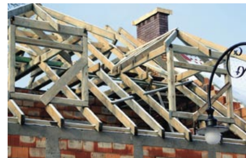
Na powstającym budynku Ośrodka Kultury w Serocku wykonano więzby dachową a przy dogodnych warunkach pogodowych wykonawca przystąpi do pokrycia dachu.
