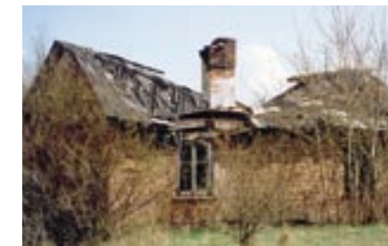
Zrujnowany dom, stan z 2005 r.
